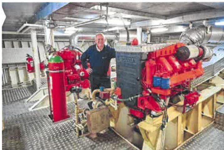
Maskinrummet på Tunøfærgeren.
